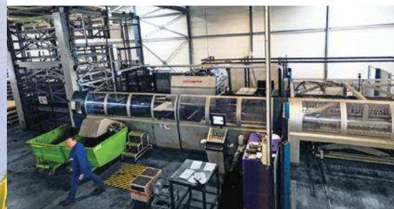
> Ligne automatisée [poinçonnage-cisaillage-panneautage] d'Étoile-sur-Rhône
